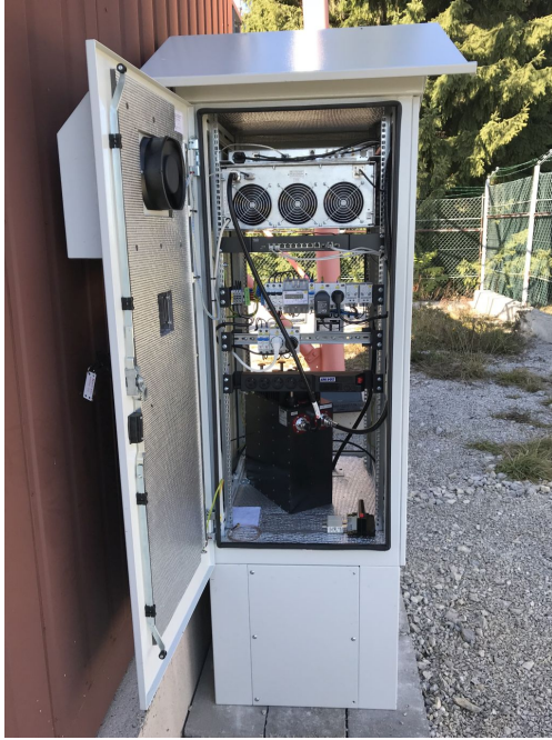
Obr. 6 – Skriňa na Panskom diele so zariadeniami T-DAB+
