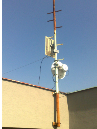
Obr. 4 – Parabola rádiorелеového spoja na budove VÚS
